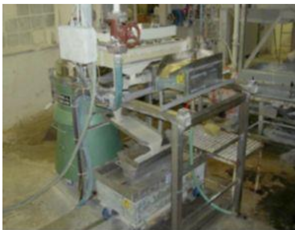
Průmyslová instalace magnetického filtru s magnety Nd-Fe-B ve dvoustupňové magnetické filtraci v technologické lince přípravy glazury pro sanitární keramiku, společnost Laufen.
