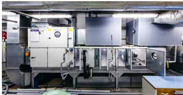
Klimatizační jednotka pro úpravu vnitřního prostředí v klimatizované komoře
