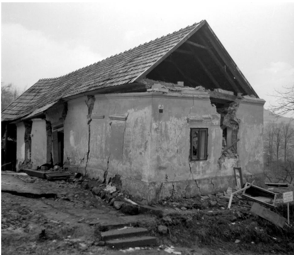
Handlová, dům těžce poškozený sesuvem. Snímek J. Rybář, 1963
